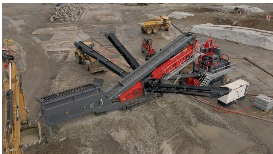
Unité de lavage
