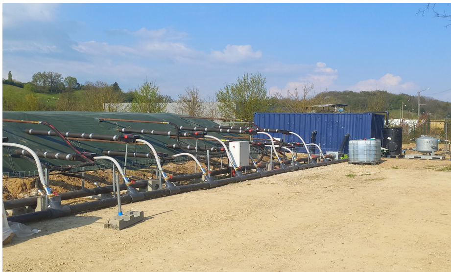
Figure 4 : installation de désorption tout électrique en pile
